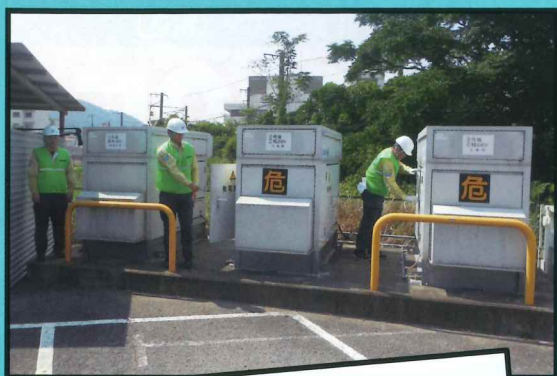
非常用発電機を稼働、 停電でも大丈夫!
